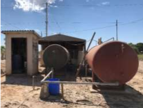
Figura 55 : Cárcamo de bombeo de agua en Ejido Tula.
