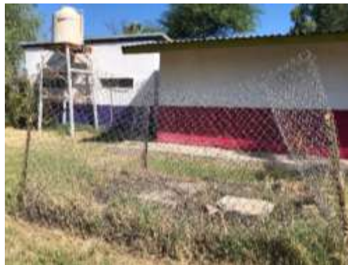
Figura 61: Fosa séptica en instalación escolar del Ejido Guanajuato.
