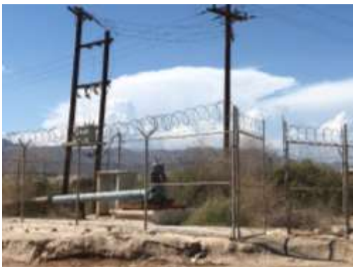
Figura 57 : Planta potabilizadora de agua "Cerro Prieto No. 6" en Colonia Seis (Granjas Lázaro Cárdenas).
