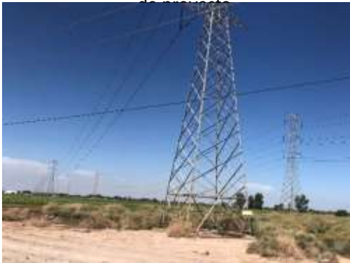
Figura 68 : Doble línea de alta tensión en Cerro Prieto No. 4 cruce con el gasoducto
